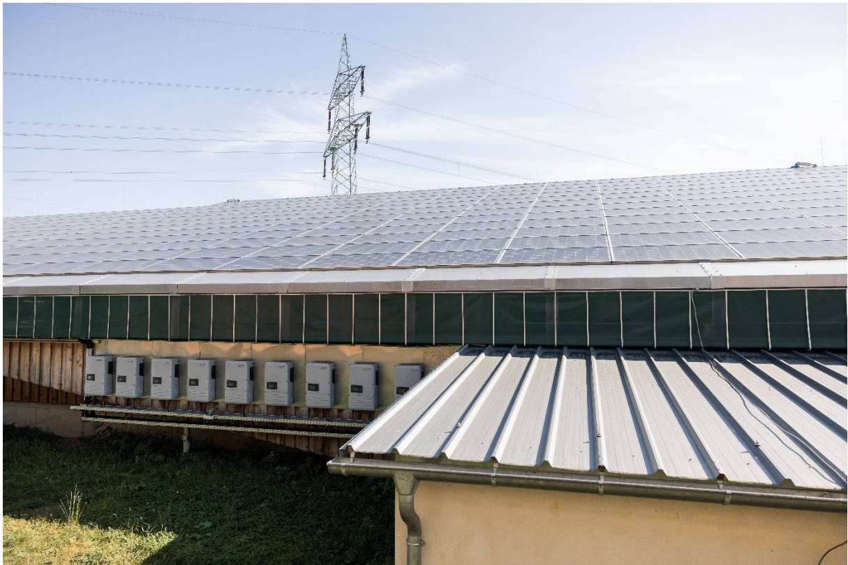
Abbildung 8: Photovoltaik mit Unterdachabsaugung auf dem Dach der Heuhalle
